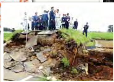
地震で約2メートルの段差ができた阿蘇市の農地を視察する政府関係者ら（2016年5月）
