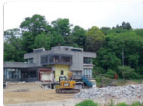
JAおおふなと本店の復旧の状況
