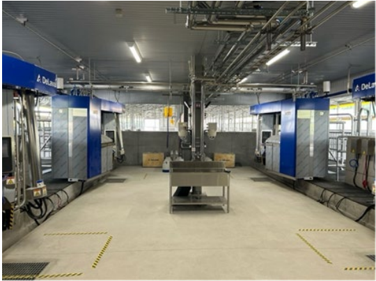
牛舎内の搾乳ロボット
