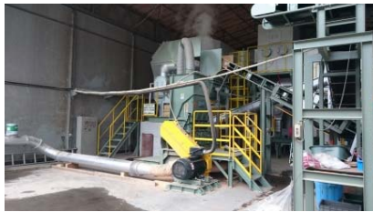
木質チップ製造設備
