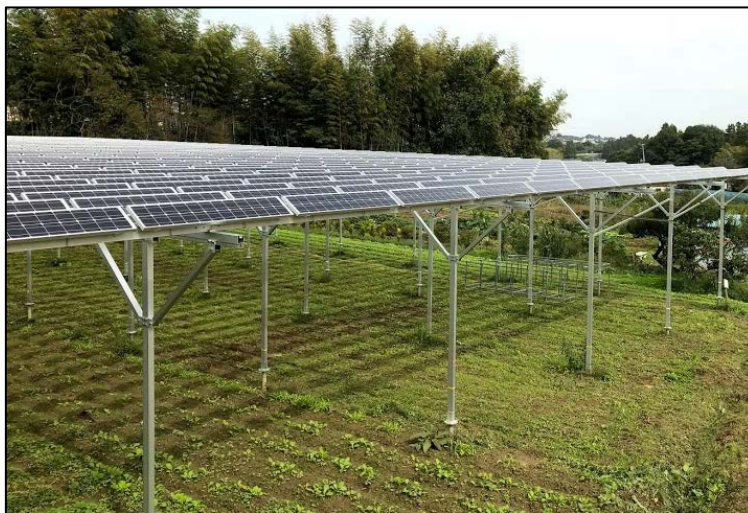
設置された太陽光パネルの様子
