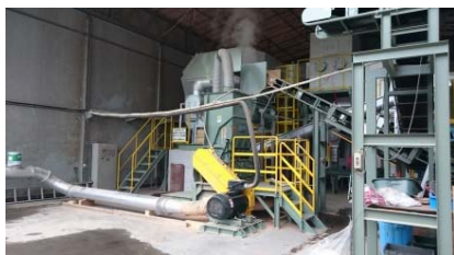
木質チップ製造設備
